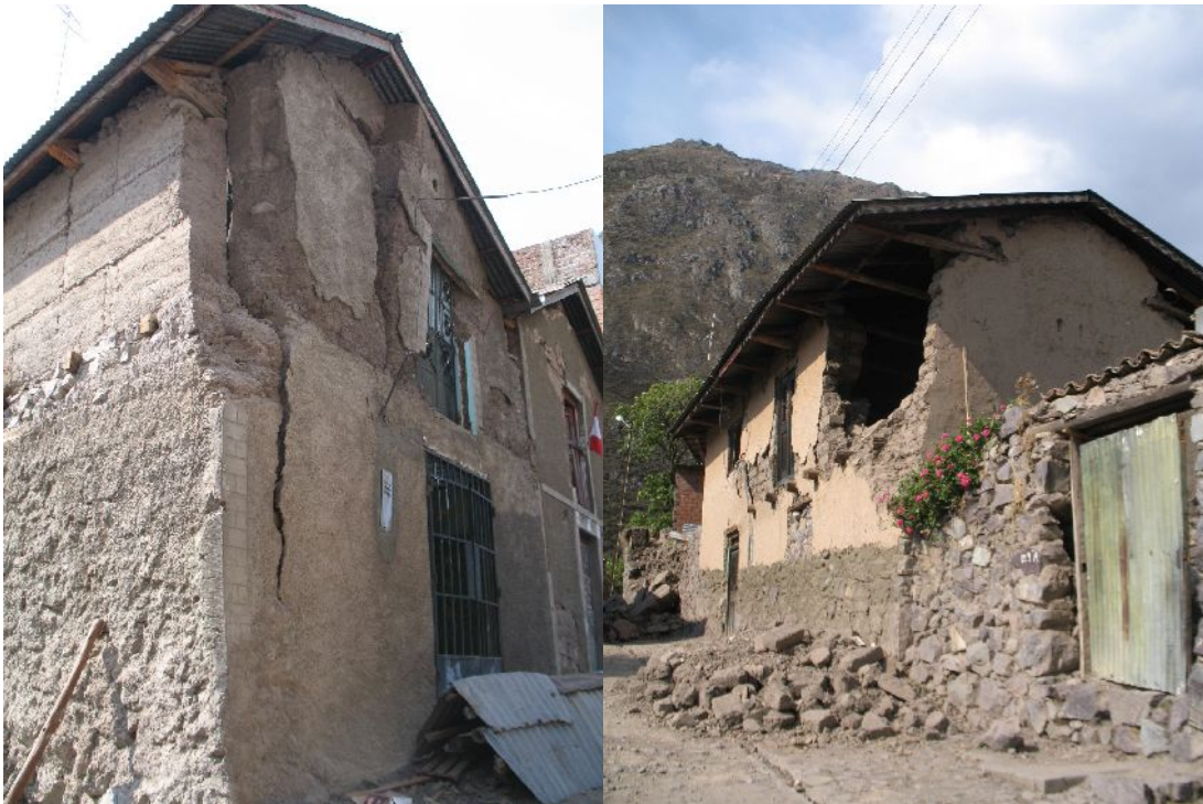
Casas rajadas y totalmente inhabitables.
